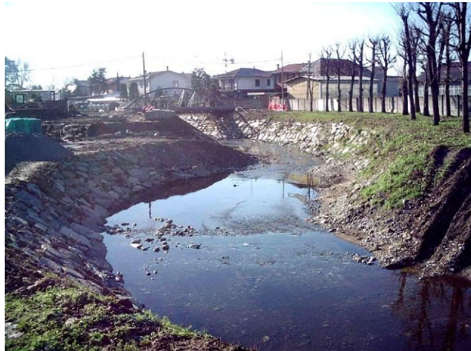
Il torrente Certesa in via Forlanini durante i lavori di sistemazione idraulica nel 2008
