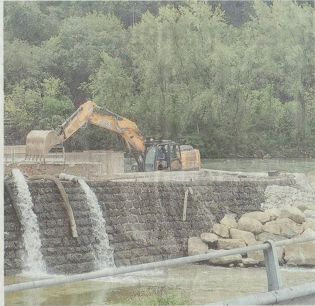
Cantiere in azione. La struttura sarà lunga 50 metri per quasi 3 metri di dislivello
